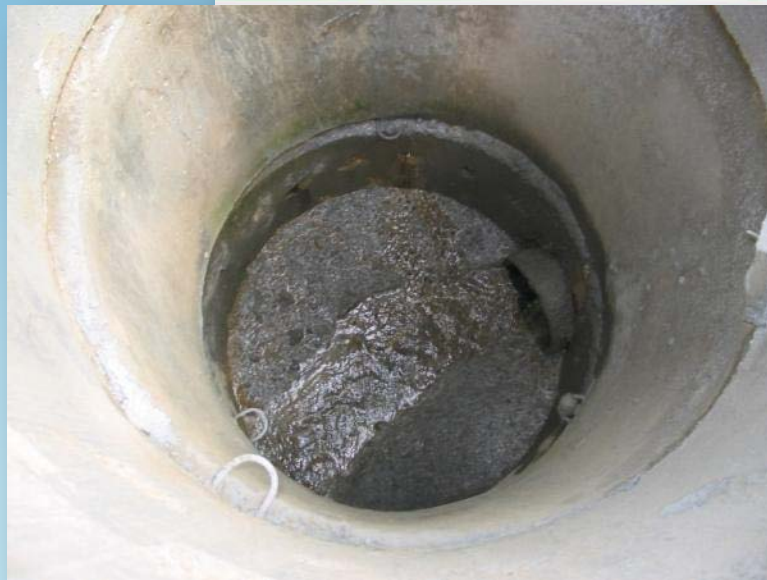
Cămin de vizitare sistem de drenaj
